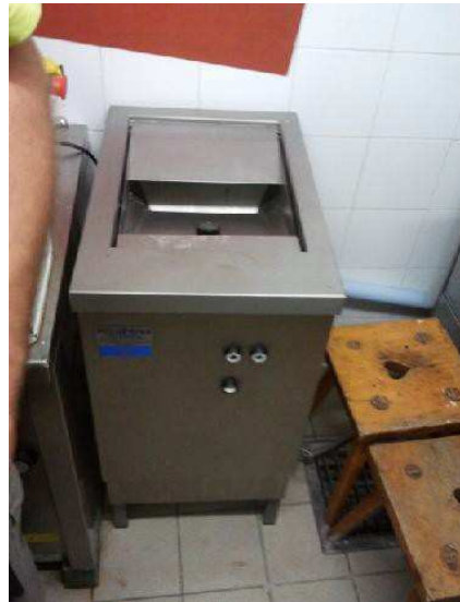
Abbildung 16 - In der Küche der Berghütte Fuciade installierter Zerkleinerer
