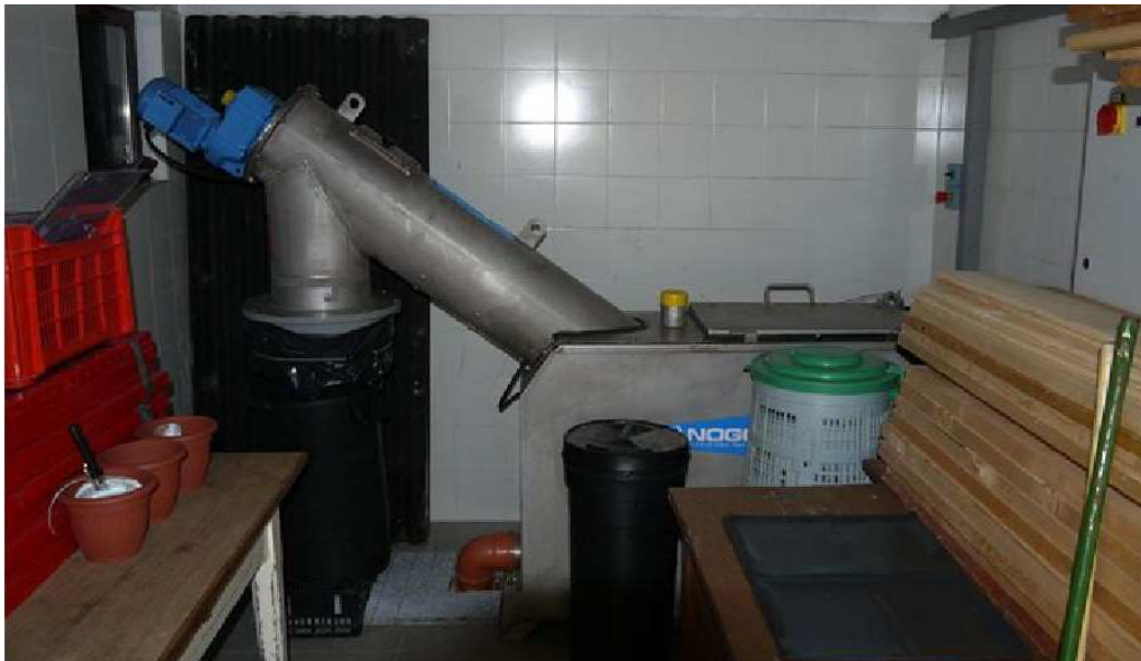
Abbildung 28 - Anlage zur Abwasserbehandlung, Berghütte Dorigoni
