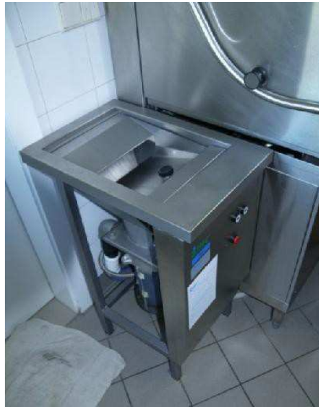
Abbildung 23 - Abflusshäcksler, Berghütte Salei
