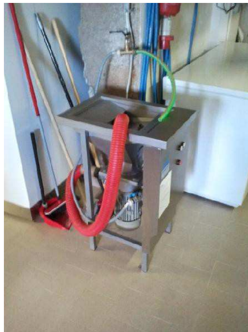
Abbildung 18 - Zerkleinerer mit Schlauch (grün) für zusätzliche Wasserzufuhr und Abflussschlauch (rot), Berghütte Des Alpes
