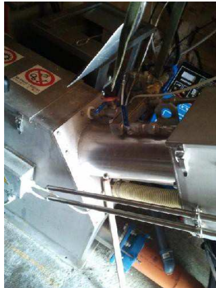
Abbildung 24 - 4cm durchmessendes Rohr des Zerkleinerers, das in ein größeres Rohr eingesetzt ist und dann mit großem Gefälle abführt, Berghütte Pian dei Fiacconi
